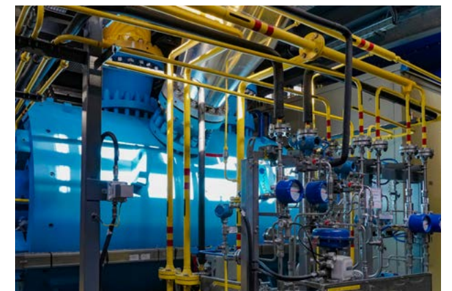
Центробежный компрессор смешанного хладагента К 905-71-1С на заводе СПГ «Криогаз-Высоцк»
