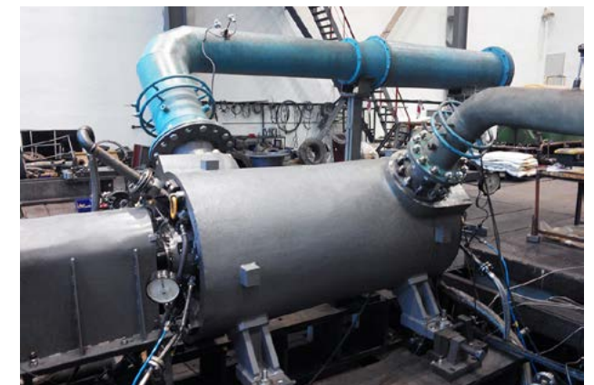
СПЧ 155-1076-2.2С для дожимных компрессорных станций ООО «Газпром добыча Уренгой»
