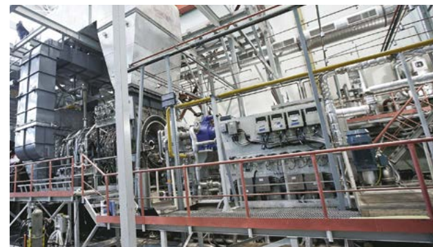
Испытательный стенд газовых турбин мощностью 32 МВт
