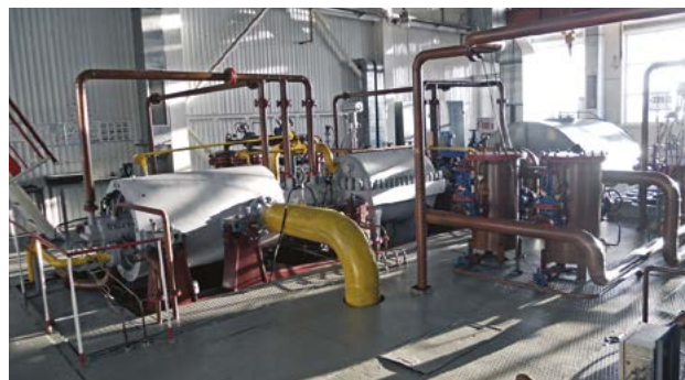
Центробежный компрессор К320-131-1 на КС Северо-Даниловского месторождения ТПП
