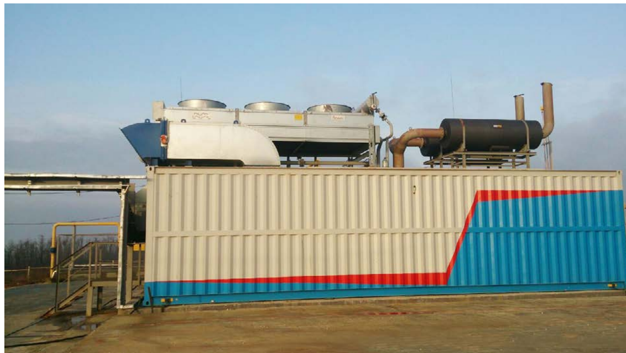
ГПЭС на КС «Казачья»
